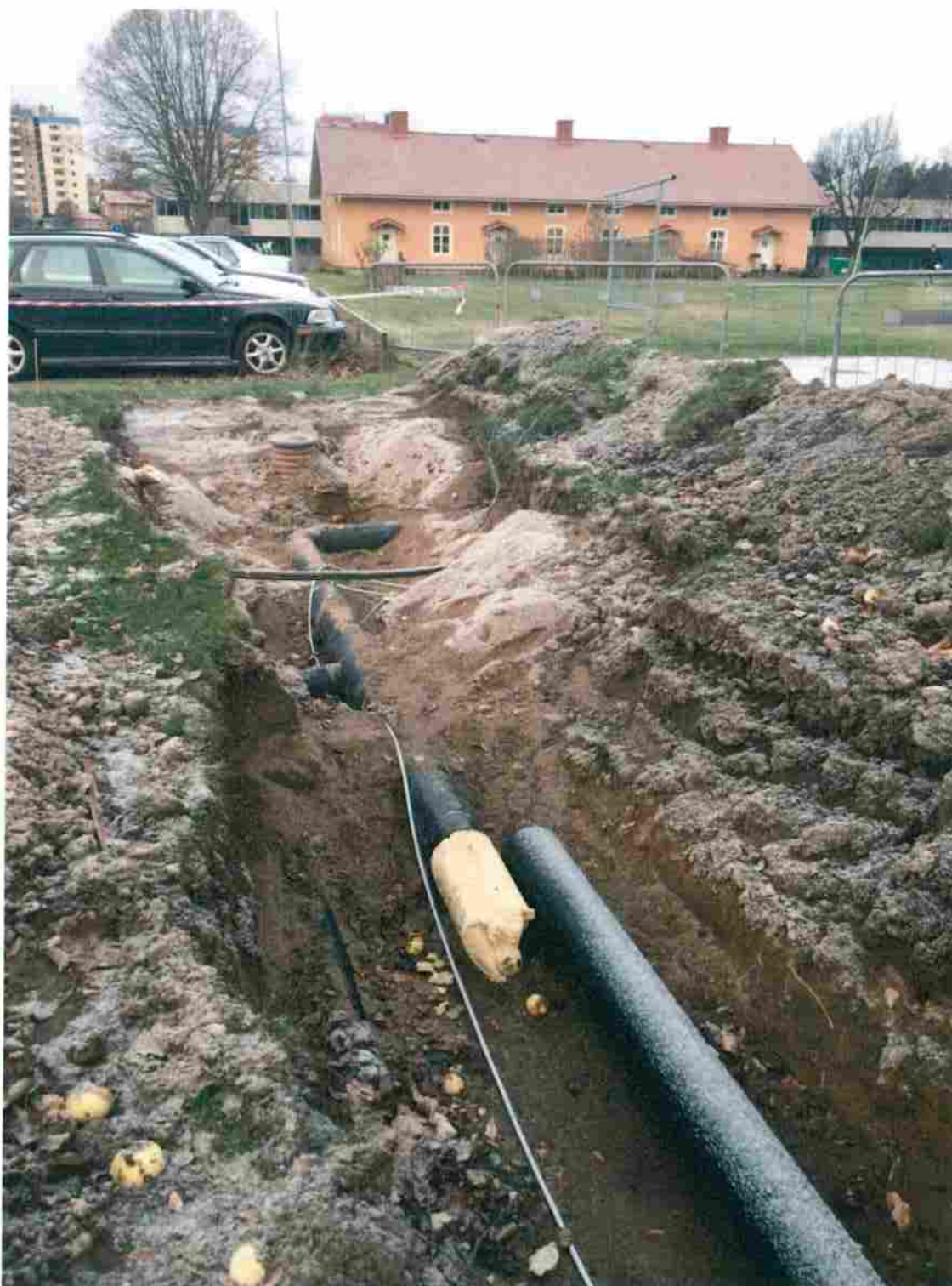
Nov 2014: Offerventilen ska öppnas - alla fastigheter på Gärdet får egna fjärrvärmecentraler!
